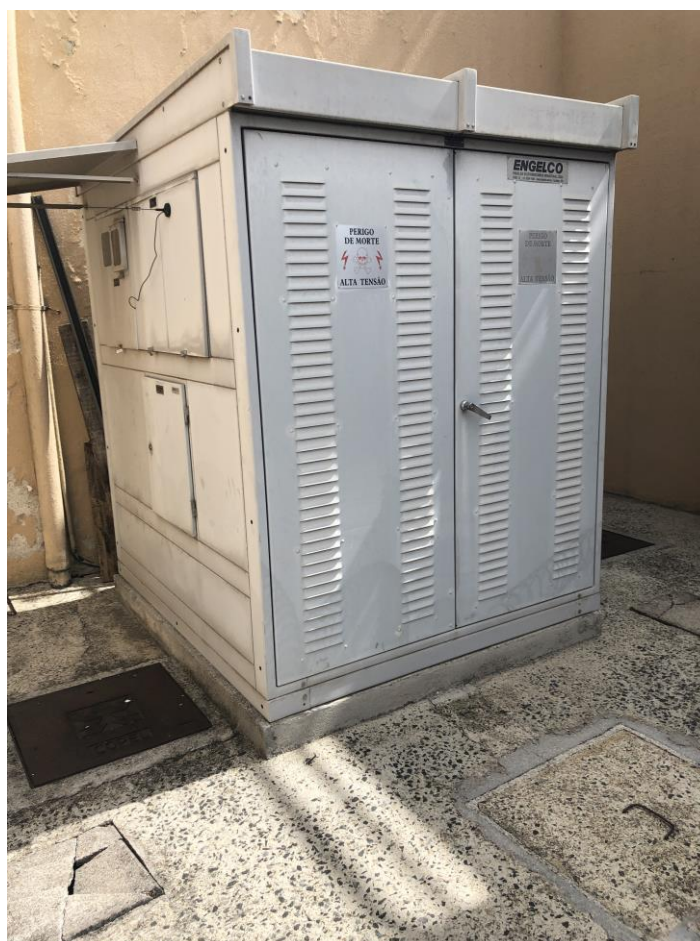
FOTO 1: CABINE DE TRANSFORMAÇÃO
