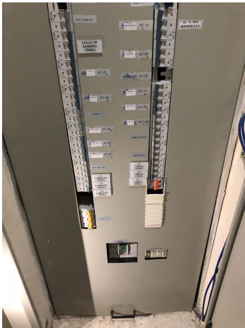
FOTO 2: QUADRO DE DISTRIBUIÇÃO QD-1
