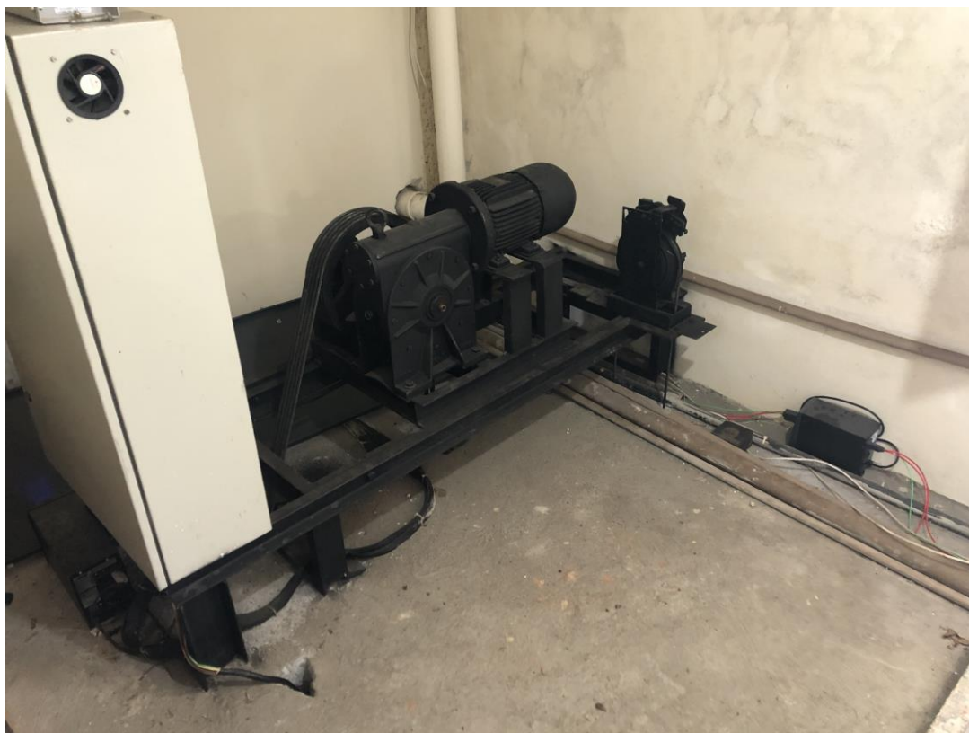
FOTO 4: MÁQUINA DO ELEVADOR
