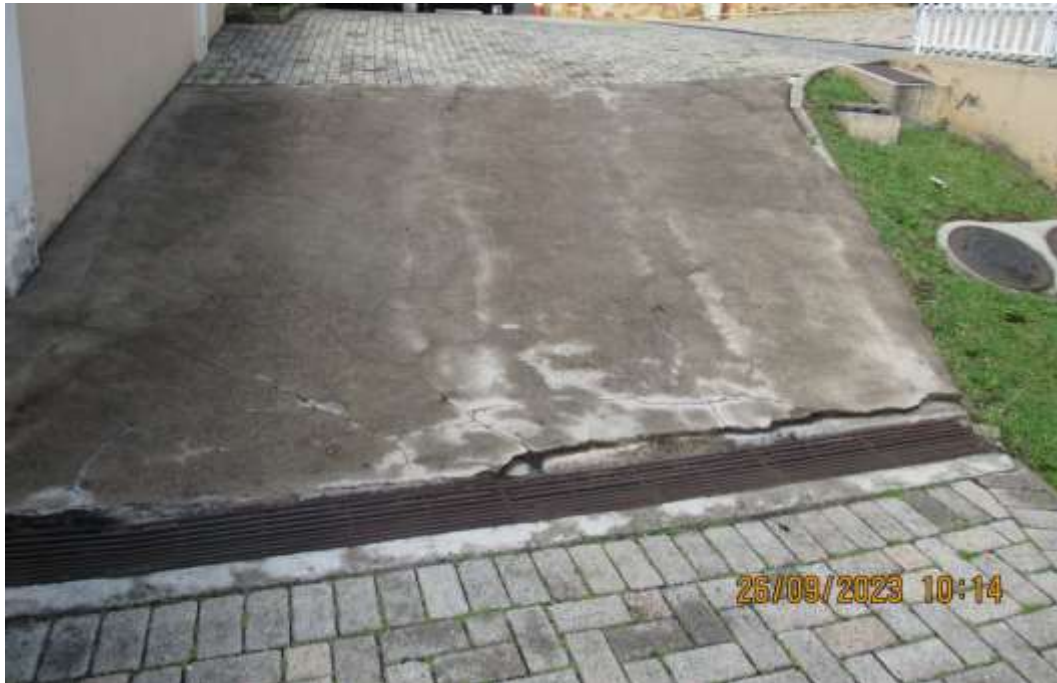
Figura 40 – Demonstração dos locais com anomalia do piso de concreto que deverão ser reparados.
