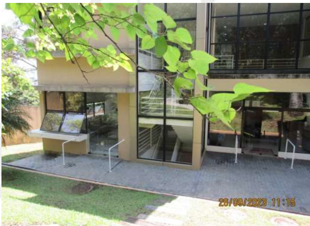
Figura 39 - Local que deverá ser executado a revisão da pavimentação em pedra Iracema.
